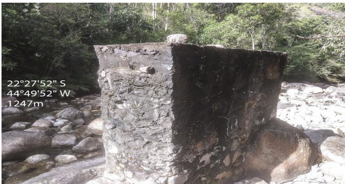
Figura 85: Ruínas de uma antiga ponte nas marges do Rio Claro. Latitude 22°27'52" S e Longitude 44°49'52". Altitude 1.247 metros. Foto de Rodrigo Souza
