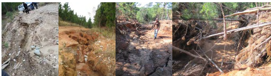
Figura 17. Ravinas desenvolvidas junto às estradas internas da Estação Experimental de Itararé.
