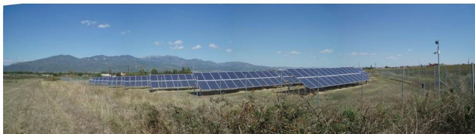
Εικόνα 2 : Φωτογραφία του φ/β σταθμού ισχύος 97 kWp.
