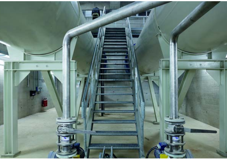
Die Abflussmessung erfolgt mittels zweier magnetisch-induktiver Durchflussmesser (DN 1800).
