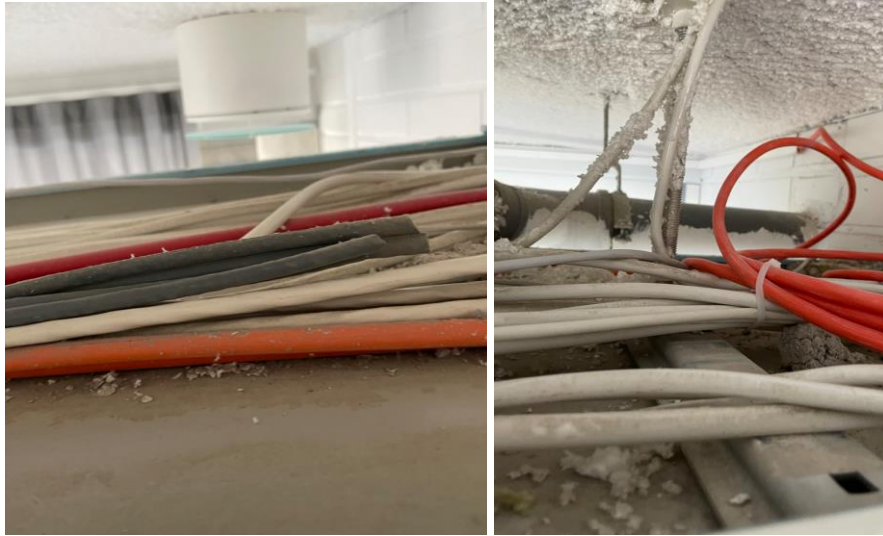
Kuvat 13, 14. Johtohyllyjen päällä havaittiin runsaasti pölyä ja muita epäpuhtauksia.
