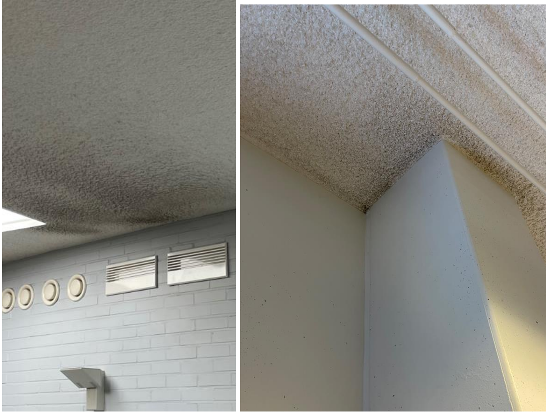
Kuva 10. Sisäkaton pinnoitteena on käytetty akustorappausta. Rappauksen pinta oli voimakkaasti tummunut tuloilmakanavien yläpuolelta. Kuva vasemmalla aulatilasta 110.
