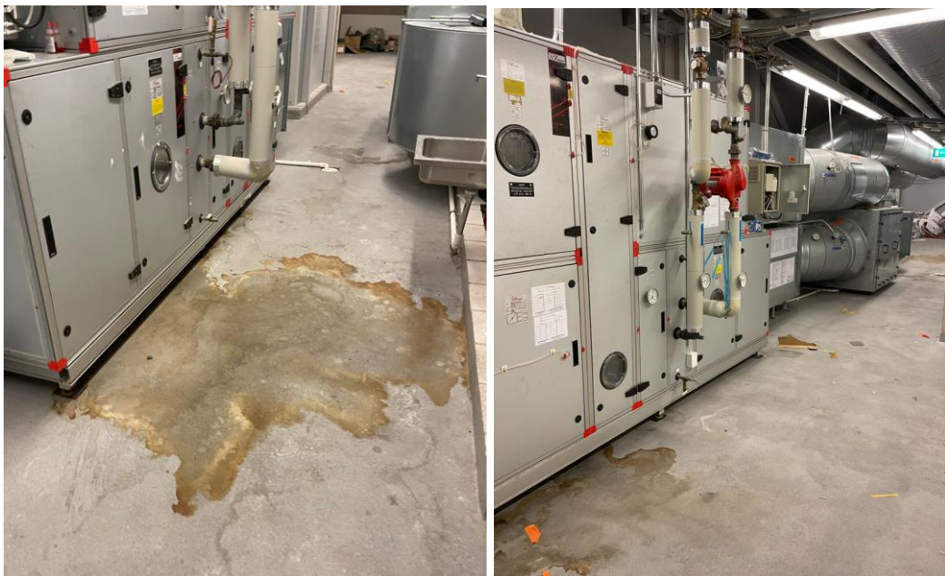
Kuvat 6, 7. Molemmista IV-koneista on valunut lattialle vettä, sillä lattialla havaittiin vanhat kuivuneet kosteusjäljet
