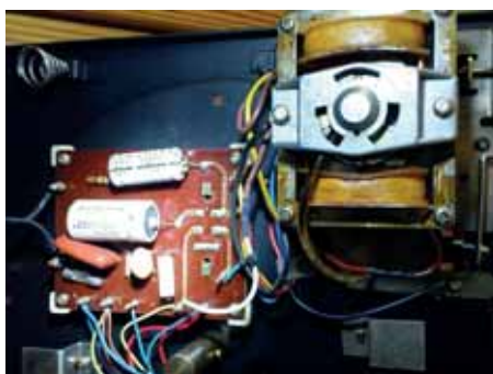
Defekter Motor mit der alten Regelung
