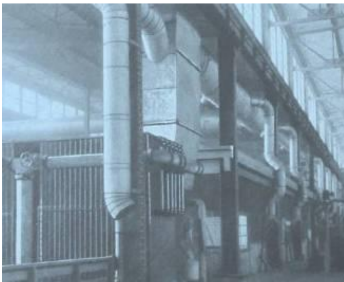
Kuvassa vuodelta 1920 on oikeaoppista lämmitetyn ilman jako eli puhallus alas. Puhallustapa on toki varsin karkea ja aiheuttaa suuria ilmannopeuksia. Isojakin koneita sijoitettiin tuotantotilaan, kun äänitaso osastoilla oli muutoinkin korkea. (Am)
