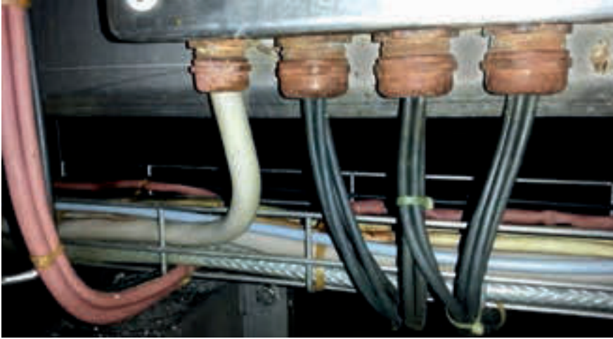
In der Lebensmittel- und Getränkeindustrie sind Kabel und Verkabelungskomponenten besonderen Belastungen ausgesetzt. Werden ungeeignete Komponenten verwendet, dann können Verschraubungen korrodieren und Kabelmäntel aufquellen, wie im Bild zu sehen. Die Komponenten verlieren teilweise ihre Funktion und es können gefährliche Situationen entstehen.
