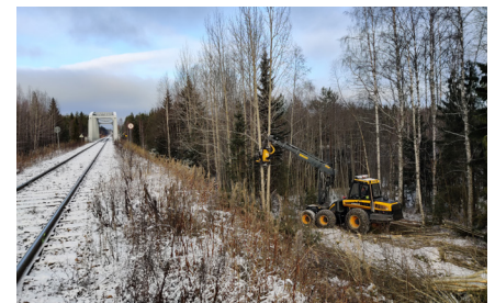
Här pågår en avverkning som beställts av Trafikledsverket. Skördarföraren har utbildning i säkerhet i banarbete och får därför röra sig också på järnvägsområdet.
