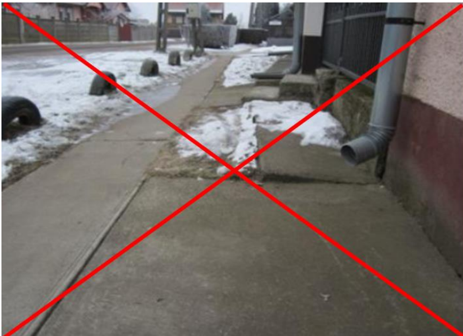
14. ábra: Helytelen csapadékvíz kivezetés 2.
