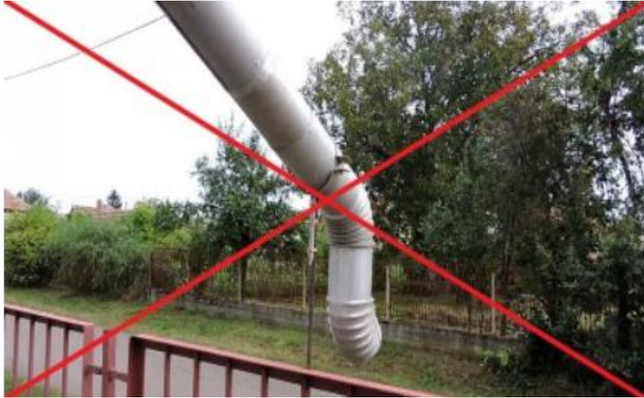
13. ábra: Helytelen csapadékvíz kivezetés 1.
