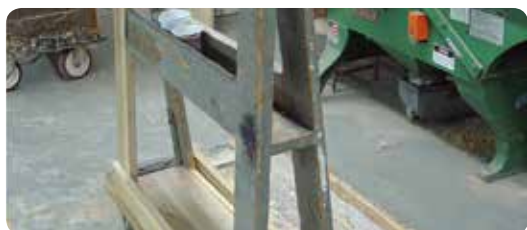
Holz – splittert und fault
