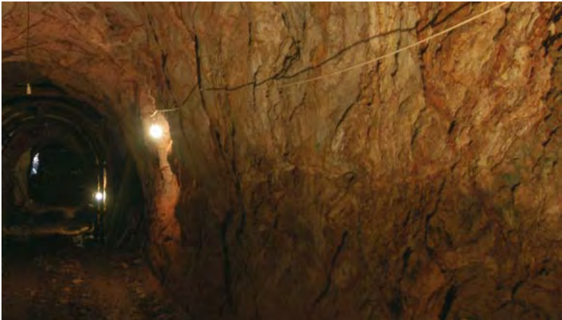
Interior del túnel Sta. María de la Mina de Peña de Hierro (Nerva). Foto ADD
