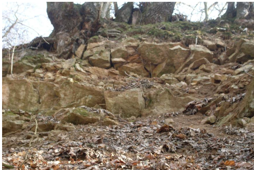
Obr. 6 Rozrušený svah u bývalého tunelu Krasíkov (L. Paščenko - březen 2011)
