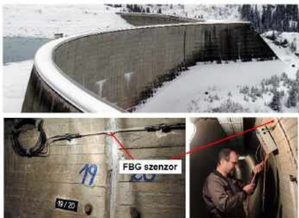
FBG érzékelővel monitorozott gát Ausztriában
