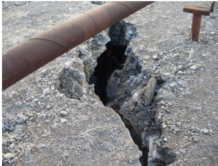
3. sz. kép: A X. sz. kazetta gátjának repedése. Készítette: a szerző
