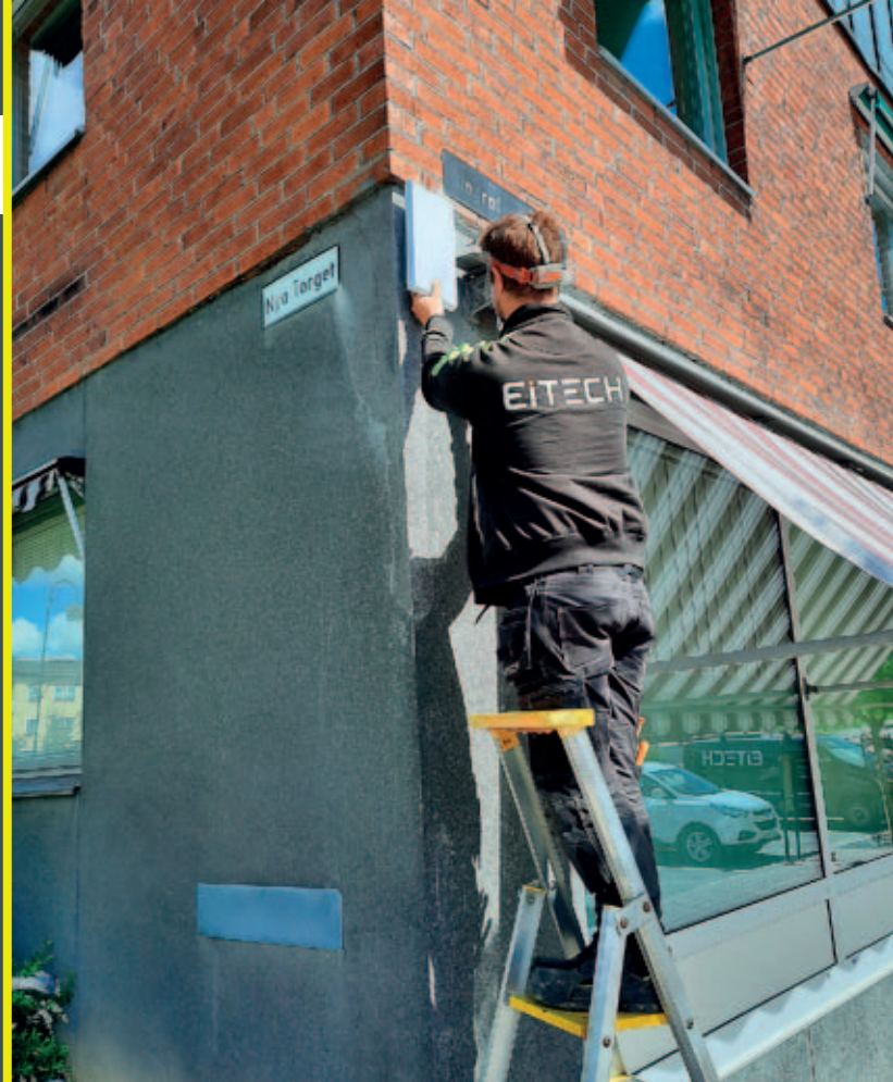
Montering av den första accesspunkten i centrum. Foto: Mikael Jonsson
