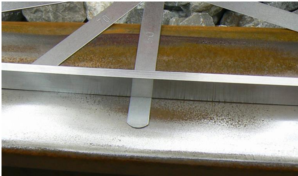
Foto 3. Profundidad de 0,5 mm vía 1 PK 11,780
