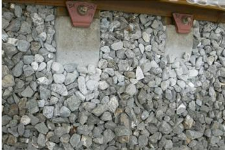
Foto 29. Balasto redondeado por el movimiento (oscilación vertical) de los durmiente en PK 10,800 vía 1
