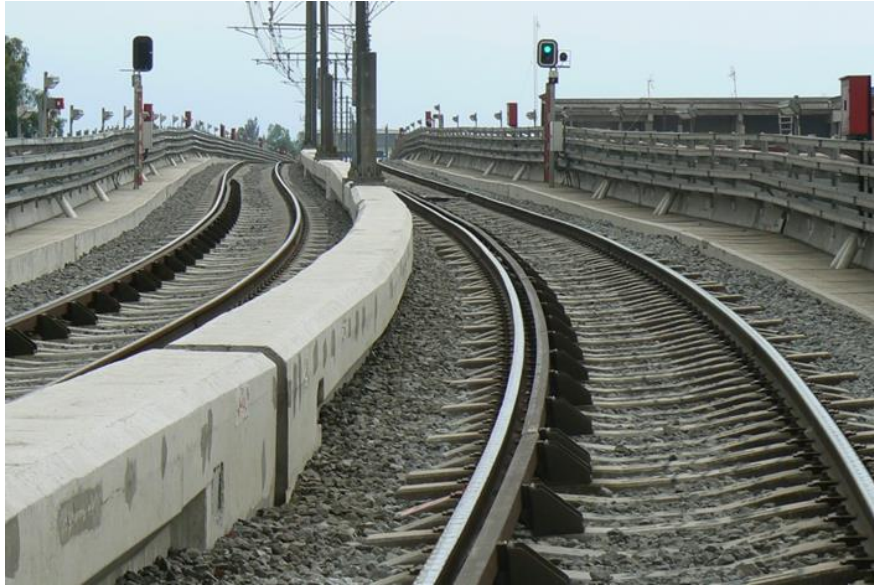
Foto 37. Defectos de nivelación en curva 7
