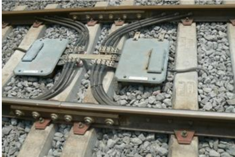
Foto 34. Juntas aislante pegadas con durmientes centrales inestables PK 16,490 vía 1
