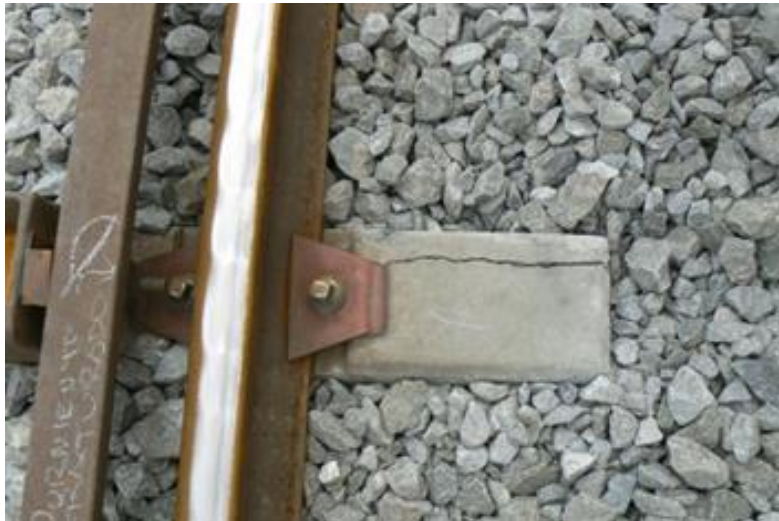
Foto 18. Durmiente agrietada longitudinalmente en PK 16,848
