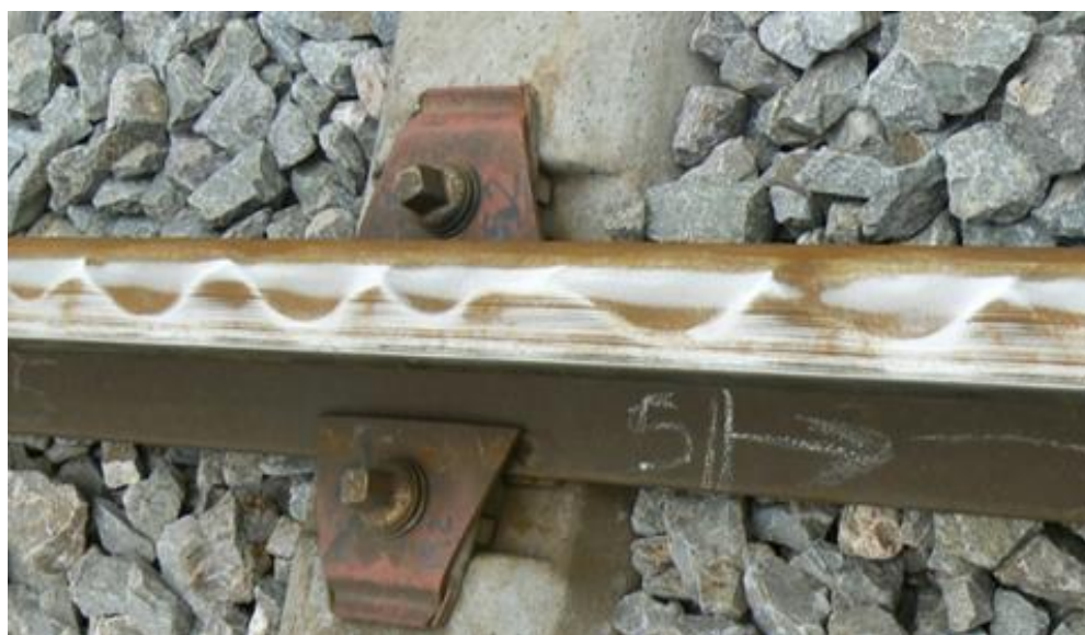
Foto 4. Rastros de movimiento transversal de la rueda por deslizamiento en vía 2 en PK 12,520
