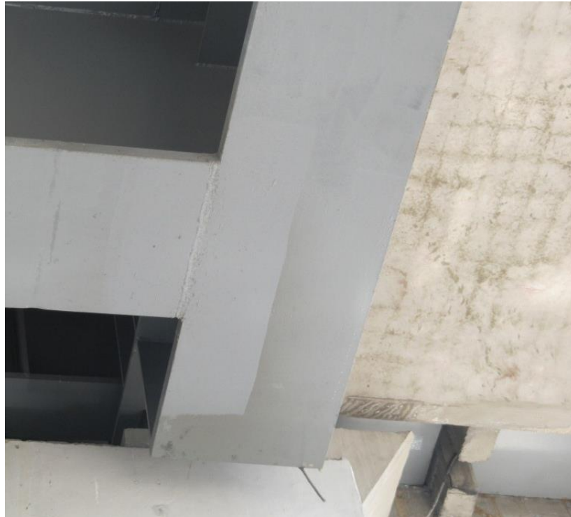
Foto 54. Patín inferior con acero quebrantado
