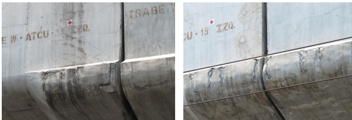
Foto 51. Calidad de los sellados de mortero en la extremidad de los capiteles
