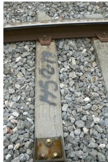
Foto 17. Durmiente roto en PK 11,704 vía 2
