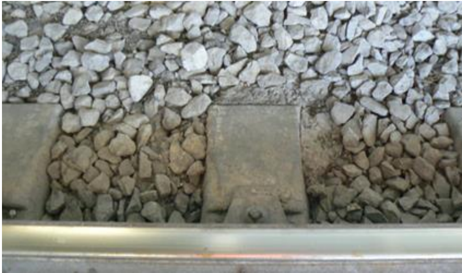
Foto 31. Contaminación por arcilla en estación de Tlahuac
