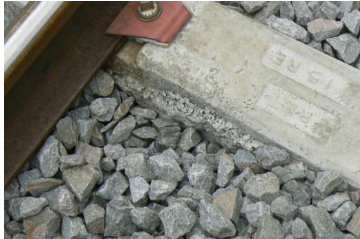
Foto 16. Durmientes con moldeado lateral anormal en PK 7,020
