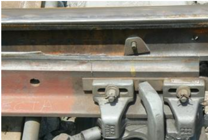
Foto 36. Aguja mellada en estación de Tlahuac
