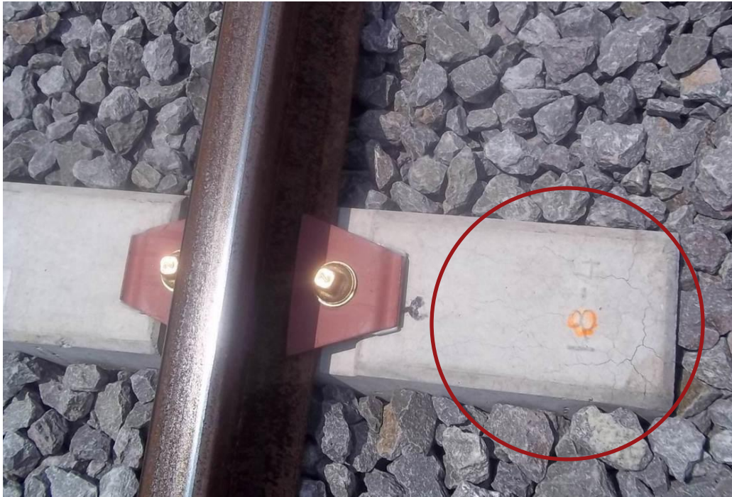
Foto 55. Fisura mallada de un durmiente de concreto
