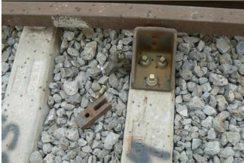
Foto 14. Brida de fijación del contra-riel aflojada en PK 16,900
