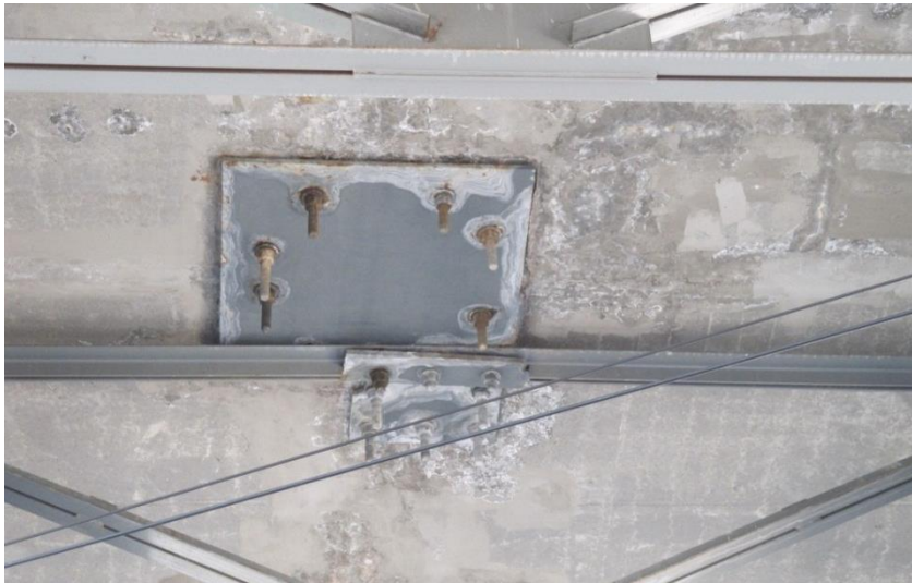
Foto 48. Anclaje de poste de catenaria debajo de la losa
