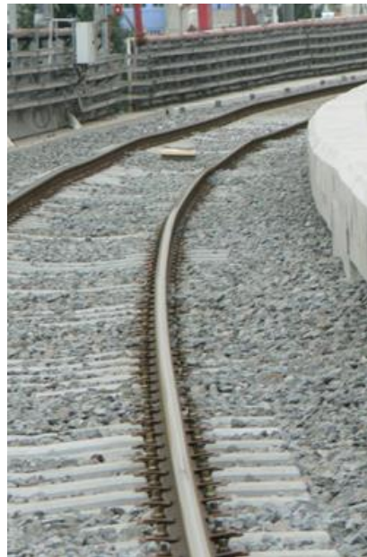
Foto 38. Defectos de nivelación en curva 10 vía 2 en respuesta a sustitución de durmientes
