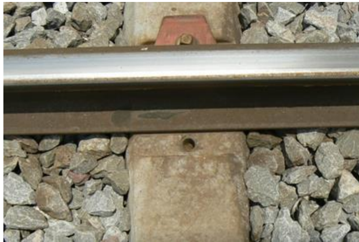
Foto 25. Fijación faltante en el PK 4,975 (con funda obstruida)
