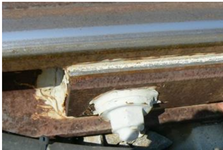
Foto 35. Junta aislante con rastro sobre la brida en la estación de Tlahuac
