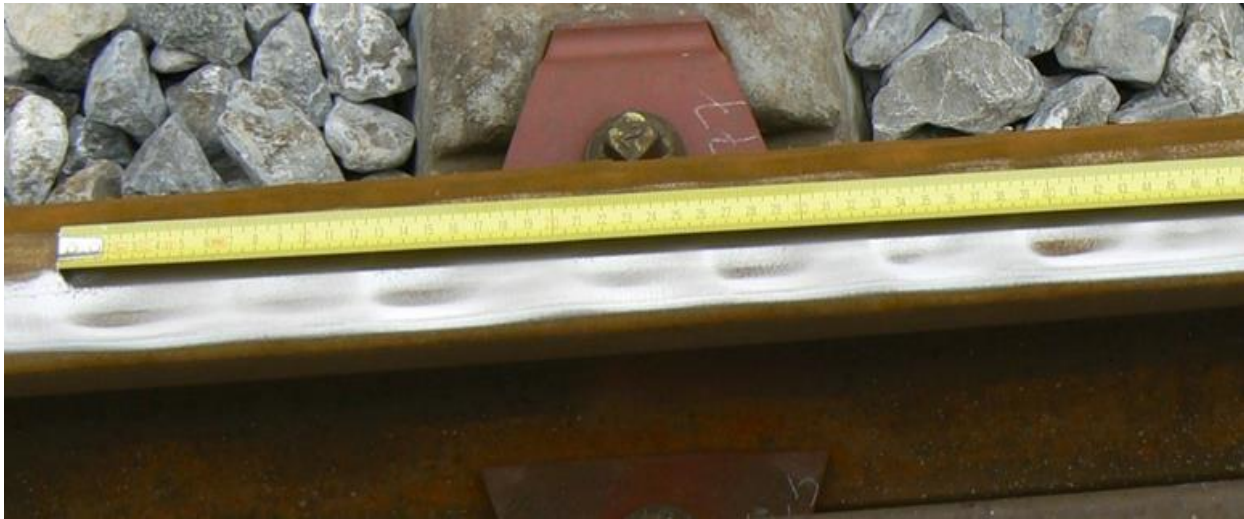
Foto 2. Desgaste ondulatorio de amplitud 6-7 cm vía 2 PK 10,905
