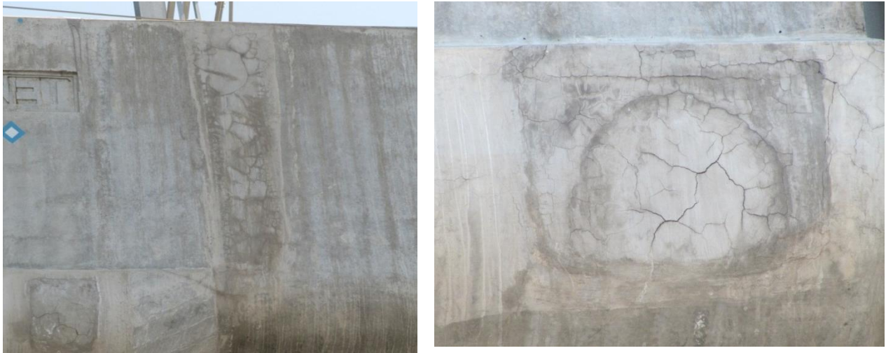
Foto 50. Fisuras del concreto y del mortero de sellado
