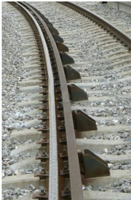
Foto 11. Soldadura angulosa en la fila baja de la vía 2 curva 12
