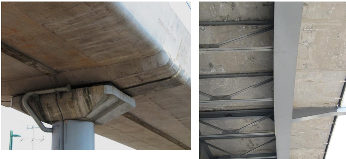
Foto 49. Variación de color del concreto no uniforme sobre vigas y tabletas
