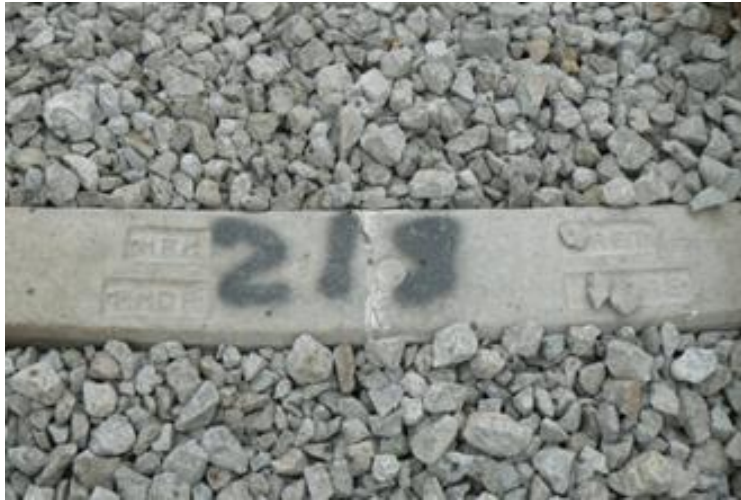
Foto 20. Traviesa agrietada en el centro en el PK 16,848 vía 1
