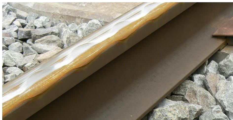
Foto 5. Rebabas en el exterior del carril de la fila alta sobre vía 2 al PK 15,320
