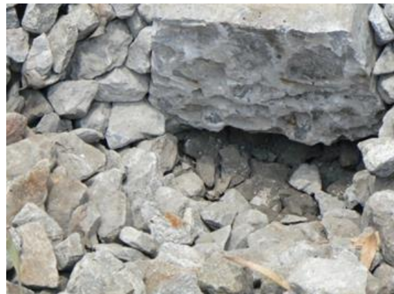
Foto 22. Cabeza del durmiente en PK 4,765 vía 1 (Después de desguarnecido)
