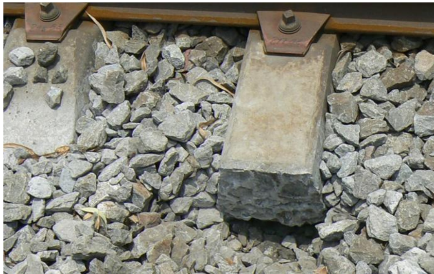
Foto 30. Balasto bajo durmiente contaminado por finos y que retienen la humedad en PK 4,765 vía 1
