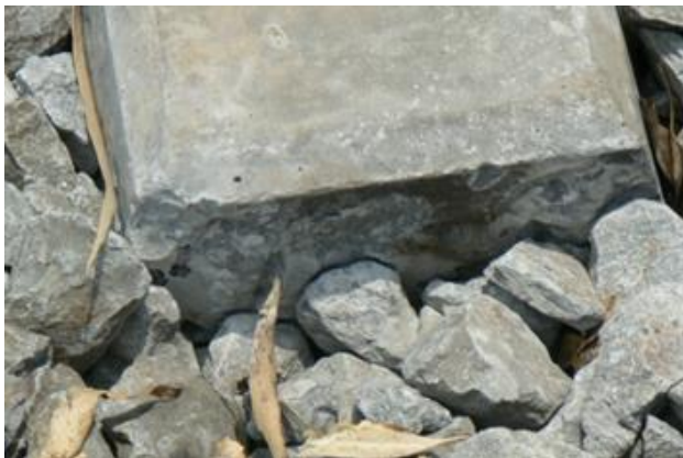
Foto 21. Balasto incrustado en el hormigón de la durmiente en PK 4,765 vía 1 (antes de desguarnecido)
