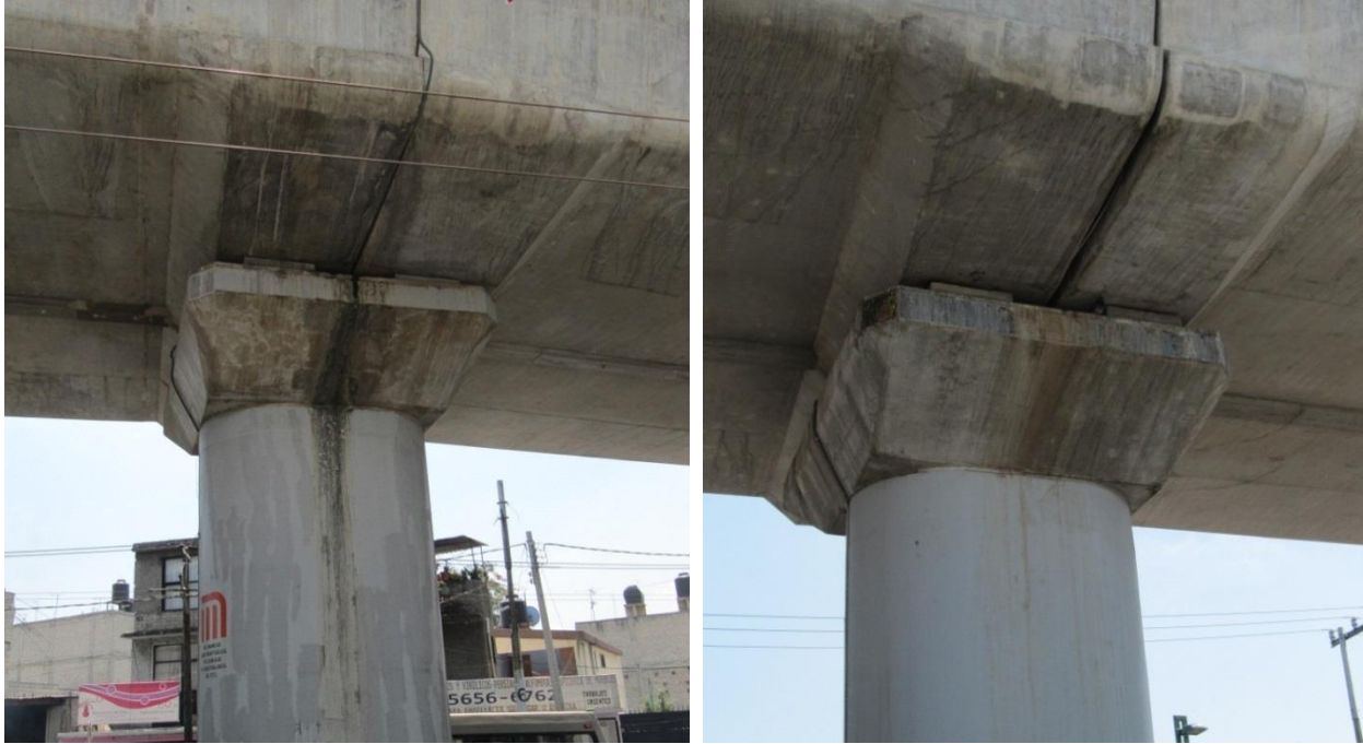
Foto 46. Problema de drenaje entre dos tramos
