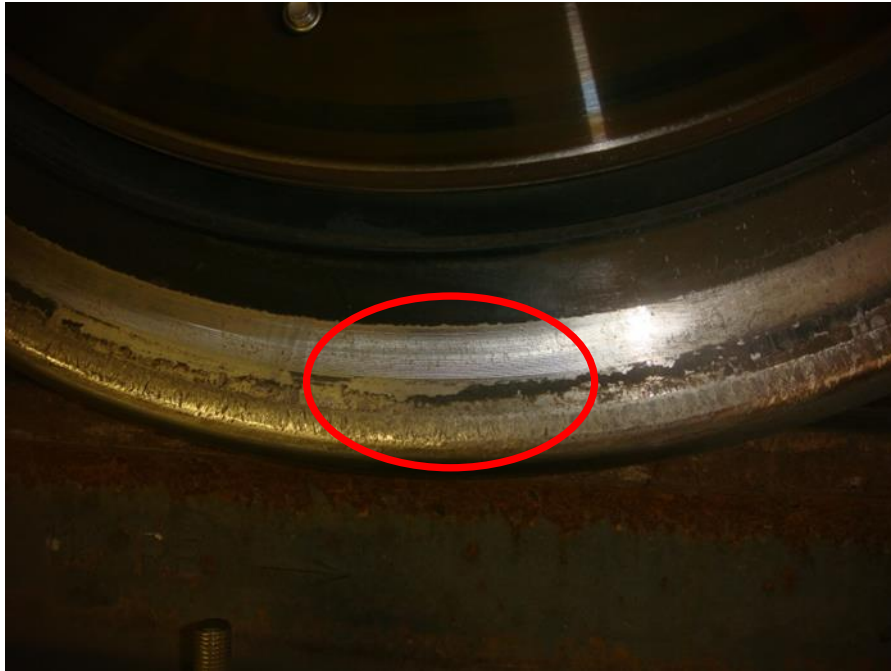
Foto 40. Desgaste anormal de la cara interna
