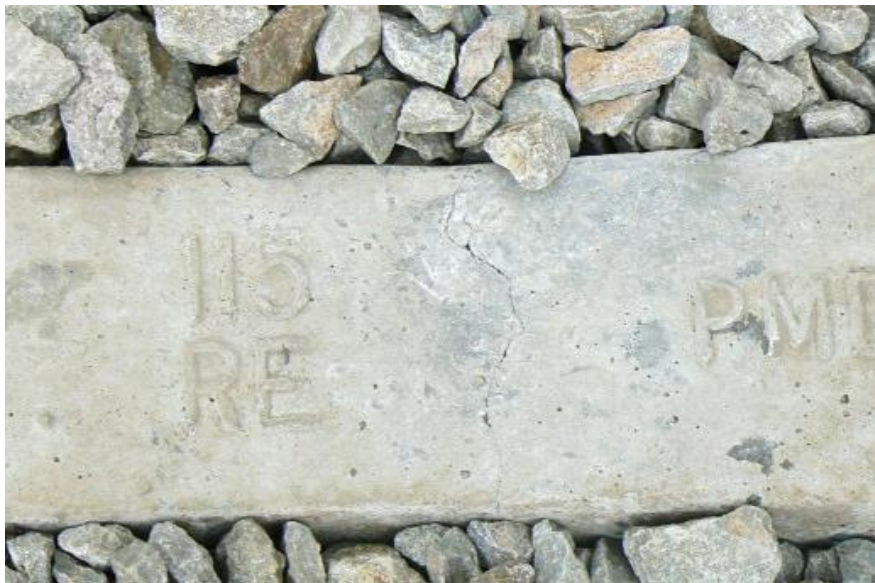
Foto 19. Durmiente agrietada transversalmente en PK 6,985
