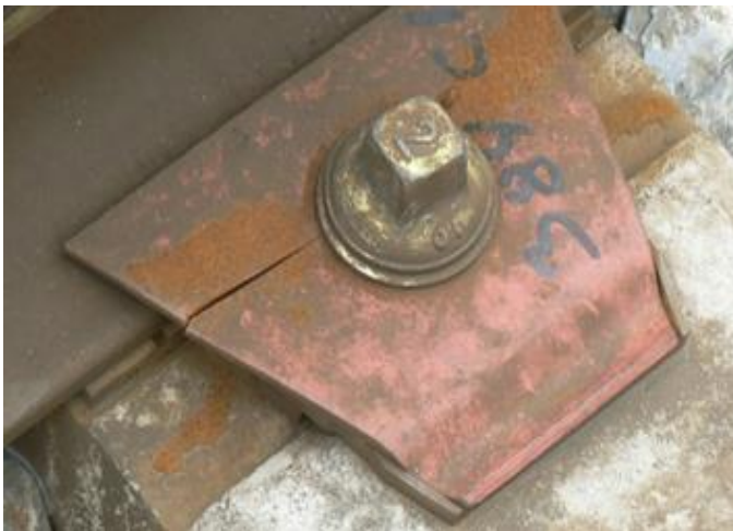
Foto 23. Fijación Nabla agrietada en PK 8,250
