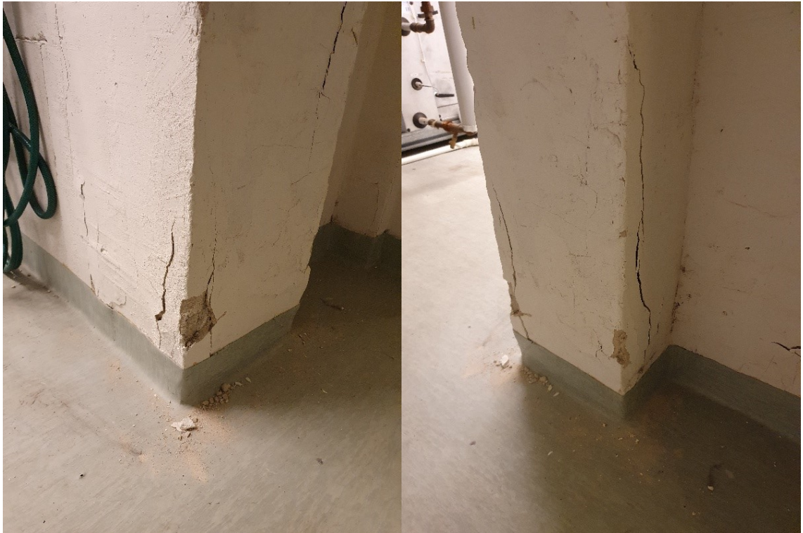
Kuva 16. Korroosioaurio kellarikerroksen kapillaarisesti kosteusrasitetussa seinärakenteessa.
