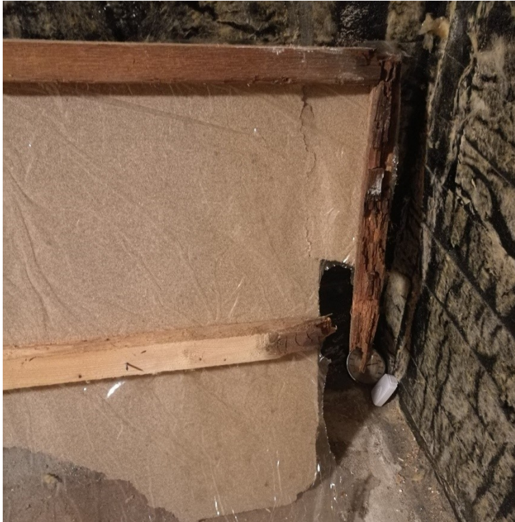
Kuva 15. Puretun seinärakenteen alaohjauspuun kapillaarikosteudesta aiheutunut laho- vaurio.
