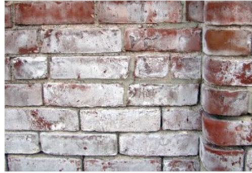
Kuva 21. Kalsiumkarbonaattia tiiliseinän pinnassa [29].
