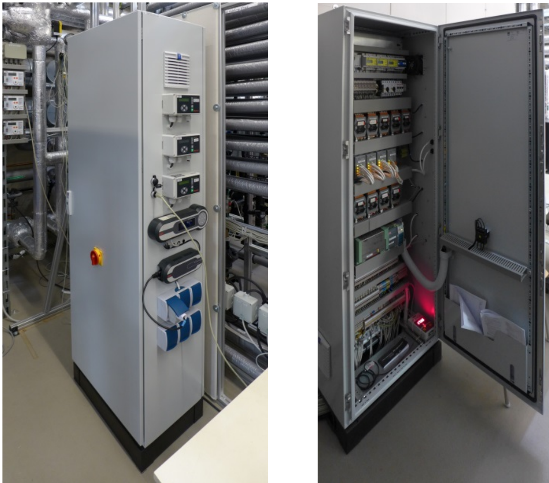
Abb. 5-10 Schaltschrank des TWI-Versuchsstandes
