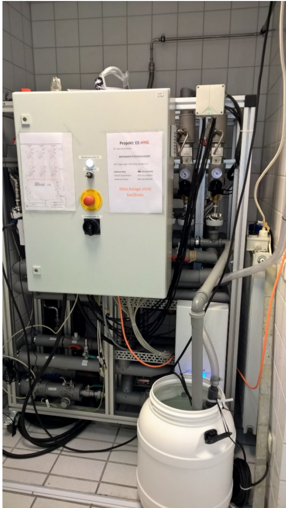
Abb. 7-25 Emulationsanlage aufgestellt am IWW im S2 Bereich im UG. Im Hintergrund an der Decke ist die Edelstahlleitung zu erkennen, welches Trinkwasser direkt vom Hauseingang zur Anlage liefert. In der Mitte der Schaltkasten, unten rechts der Abwasserbehälter. Unten in der Mitte sind die Zirkulationsstränge zu erkennen.
