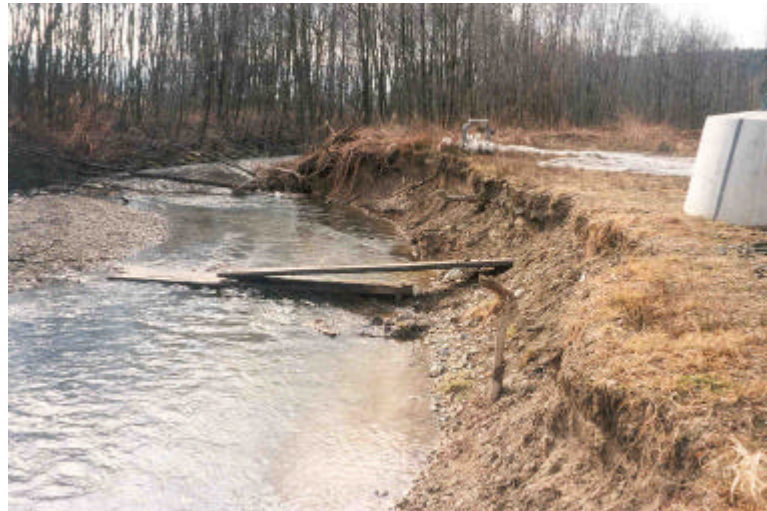
Abb. 5.11: bei M 2087, Pilgersdorf, Uferabbruch und Auskolkungen des Zöbernaches in Richtung Mastfundament (rechts); März 1999
