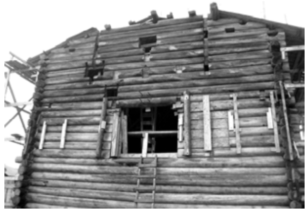
Рис. 5. Западная стена трапезной со следами реконструкций, проемом для дымника. Фото В. А. Титова
