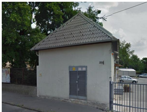
10/0,4 kV-os épületben elhelyezett transzformátor a Károlyi István utcában
