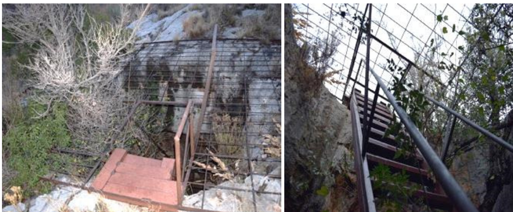
Figura 11. Infraestructura colocada en la entrada de la cueva para evitar el paso a personas ajenas. Se adaptaron rejillas para permitir el paso de fauna, así como se acondicionó una puerta y escaleras para la seguridad de los visitantes.
