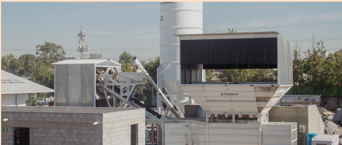
Recycling plant, México.
