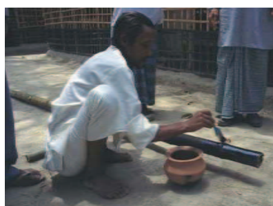
Fig. 5.5.39. Colocación del aceite protector en la base del poste del poste de bambú. Fuente: [5]
