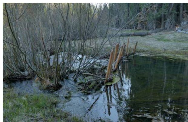
Barrage imitant le travail du castor pour retenir l’eau sur la terre © Suzanne Husky, Cristina Valverde, 2022
