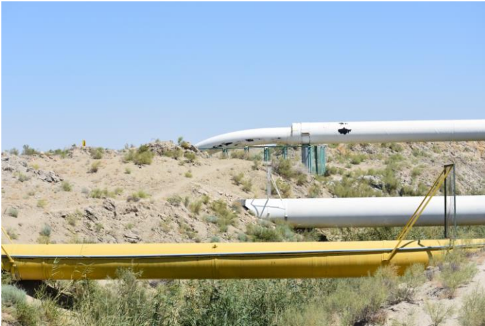
Фото 7 Линии газопроводов над коллектором. Точка Z-3
