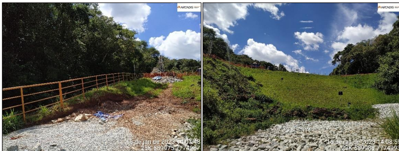
Figura 1-28 - Visão geral dos locais classificados como Maciço da barragem de Menezes I (esquerda e direita)
