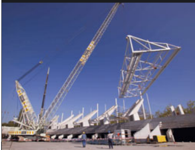
Der Demag CC 1100 hebt die 40 Tonnen schwere Dachkonstruktion des neuen Wankdorfstadion in Bern ein. Drei der Europameisterschaftstadien sind bereits umgebaut oder – wie im Falle Bern – neu errichtet worden.
