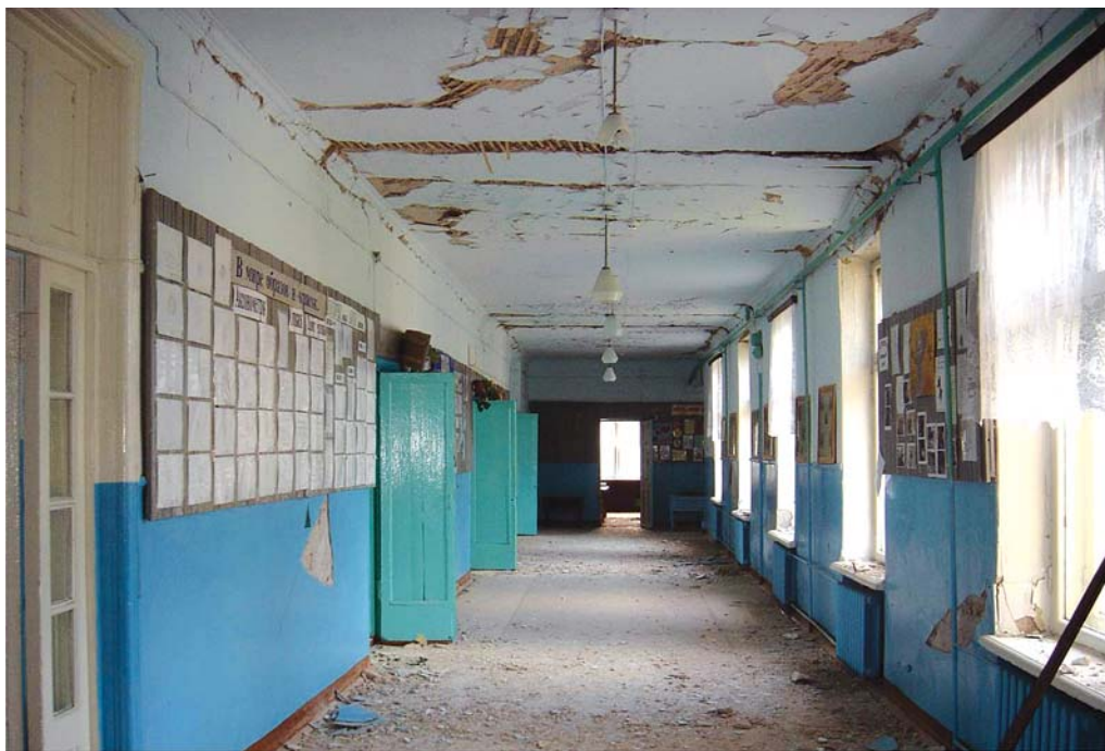
Рис. 9.11. Повреждение зданий при Култукском землетрясении 2008 г. (фото сотрудников ИЗК СО РАН) [Леви и др., 2009].
