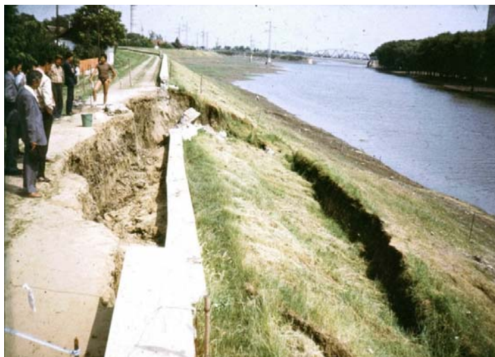
13-79. kép. Zagyva jp. 1+324 – 1+350 szelvények közötti suvadás 1985-ben.
