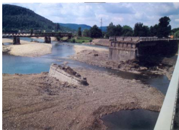
13-117. kép. A Nagy-ág torkolatánál 1998-ban az áramló víz elmosta a hídpillér környezetében a talajt, a pillér megsüllyedt, ami híd lebontásához vezetett.
