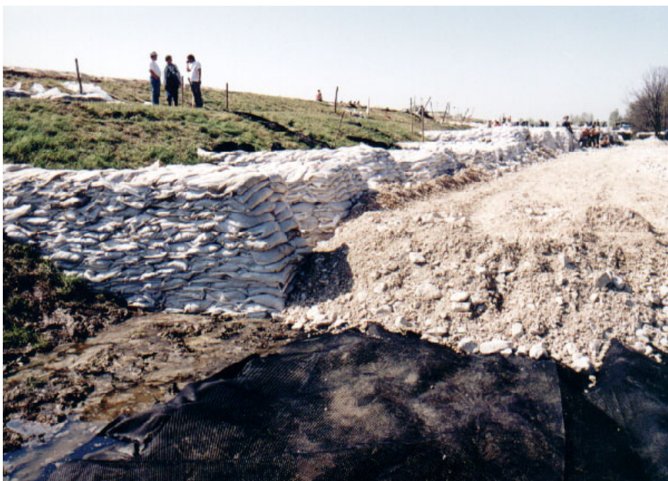
13-152. kép. Árvízvédelmi út építése, mely megtámasztja a töltést és ellennyomást ad az altalajnak.
