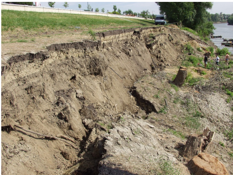
13-80. kép. Vízdali suvadás Szolnok téglaházi szakasz, újvárosi gát.
