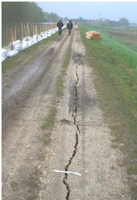
13-63. kép. Duzzadási repedés a szelevényi suvadásnál.
