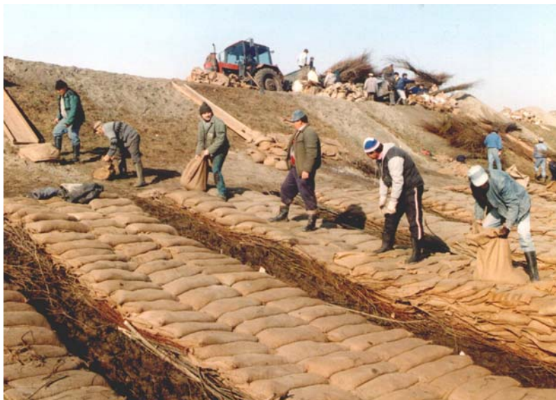
13-52. kép. Átázott töltésrészű leterhelése. A víz kifolyásának biztosítására a leterhelés rőzsére került.
