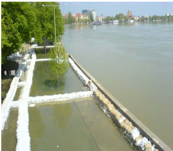
13-105. kép. Szegeden a 2006. évi árvíznél ellennyomó medencék kialakítása a partfal mögött. A folyó vízszintje és az első ellennyomó medence vízszintje között csak kis különbség van, mert a partfal nem tartja vissza a vizet.
