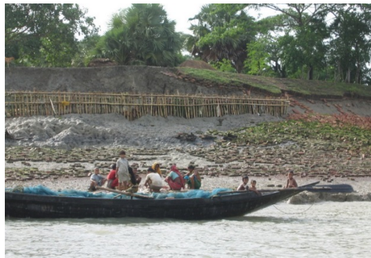
13-43. kép. Hullámvás hatására tönkrement rézsű Bangladesben. A téglaburkolat maradványai megfigyelhetők a képen. A rézsű ideiglenes védelmét a kettős bambuszor látja el.
