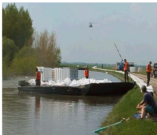
13-144. kép. Vízi szállítás a Hármaskörös jobb parton a Kútréti I. suvadásnál.
