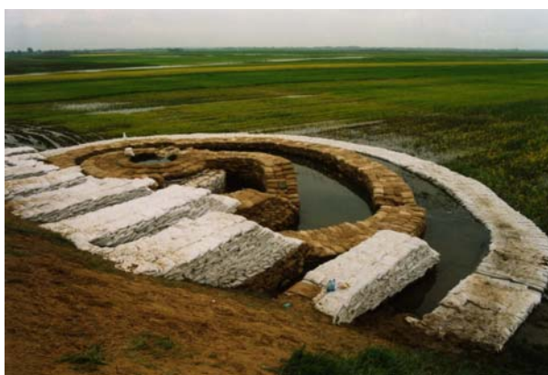
13-99. kép. Tiszasasi buzgár a 2000. évi árvízvédekezéskor. Felhasználva ~ 50 000 db homokzsák a vízoldali védekezéssel együtt.
