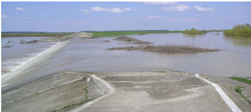
13-21. kép. Üzemben a fix bukós tamáshidai árvízi szükségtározó.
