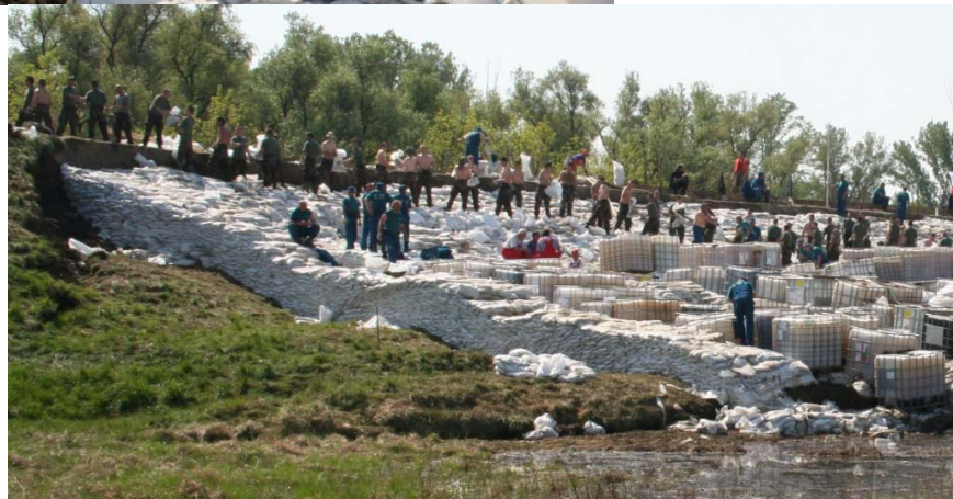
13-75. kép. Helytelenül kialakított megtámasztás, amiből leterhelés lett. Ennek is köszönhető a talaj kigyűrődése a mentett oldali lábnál.
