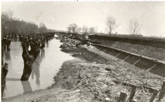
13-24. kép. 1940. áprilisi orkán hatása a téglarézsűburkolatra Tiszaderzsnél. A csonkolt fűzek hullámvédélme elhanyagolható volt.
