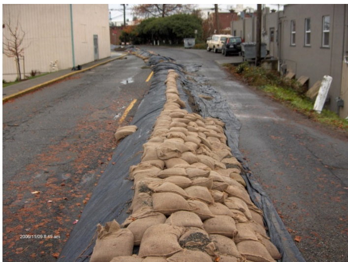
13-9. kép. Kellően át nem gondolt helyre épített homokzsákból készült nyúlgát (lehetetlenné teszi a mindkét irányú forgalmat).
