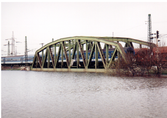
13-116. kép. Zagyva vízszintje elérte a szolnoki vasúti híd alsó élét 2000-ben. Az elhaladó személyvonat mögött látszik a híd leterhelésére beállított kővel rakott tehervonat.
