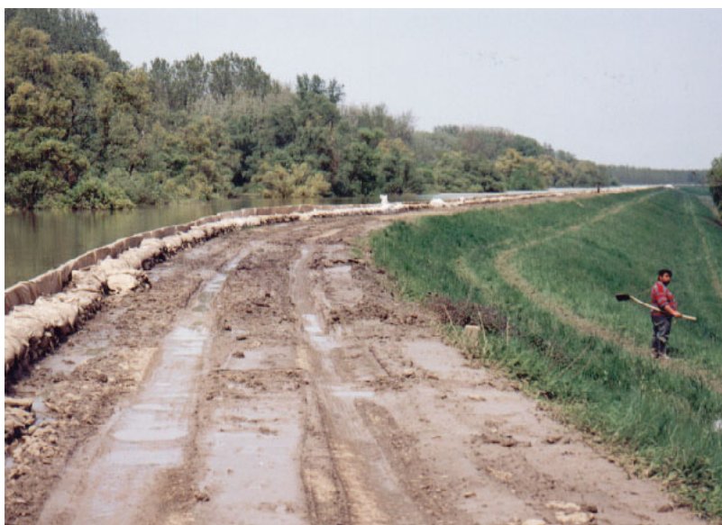
13-1. kép. Felázott, járhatatlanná vált korona a gát felső rétegének öregedése miatt kialakult szivárgás hatására.
