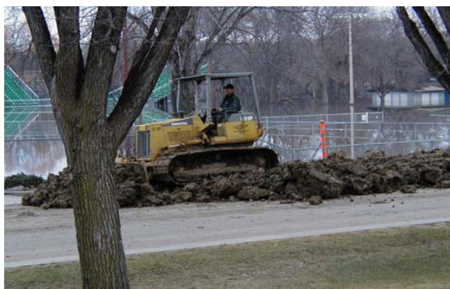
13-7. kép. Földből készülő nyúlgát építésénél a rossz anyagnyerőhely miatt túlságosan darabos a beépített anyag. A földtoló nem tud megfelelően tömöríteni, tömörítő eszköz szükséges.
