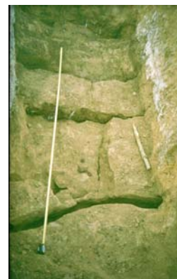
5–8. kép. Zsugorodási repedés a Tisza bp. töltésében (Óballa) (KÖTIVIZIG, 1990)
