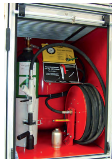
Feuerlöschcontainer von vorne
