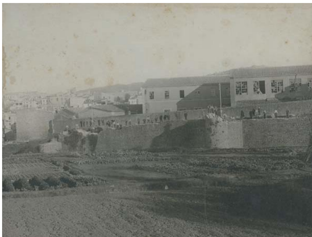
Fig. 105: L'enderrocament del primer tram de la muralla del Mercadal, amb els seus treballadors demolint part del mur i les torres, 1901-1908. Ajuntament de Girona. CRDI (Antonio J. García Asensio)
