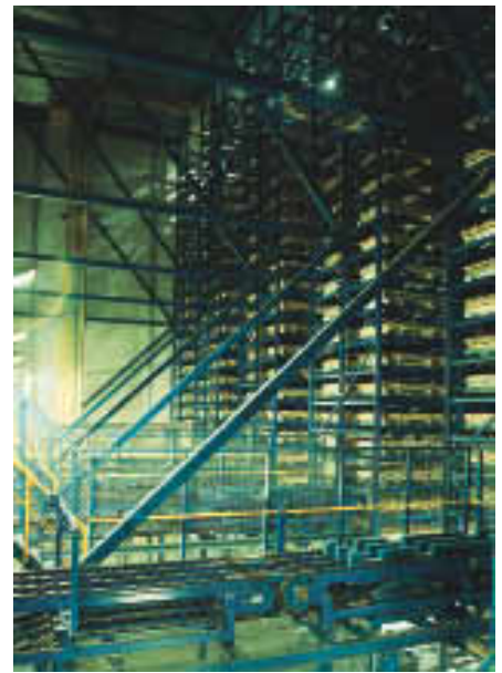
Vuonna 1998 valmistuneen laajennuksen yhteydessä rakennettuun, täysin automaattiseen korkeavaraan mahtuu enimmillään 11 000 teräspakettia odottamaan lastausta ja toimitusta asiakkaille.
