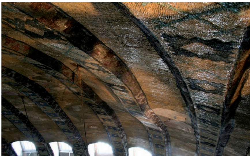
Abb. 12: Deformation der Rippen
