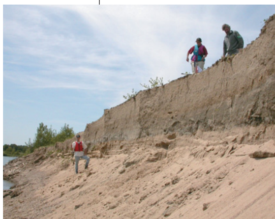
Les talus : une formidable capacité à recharger le lit mineur en sédiments.
