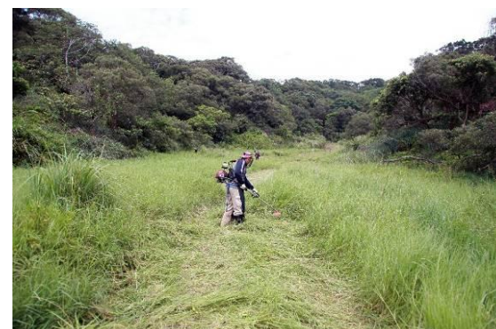
照片 24：走道定期以機械方式割除高草
