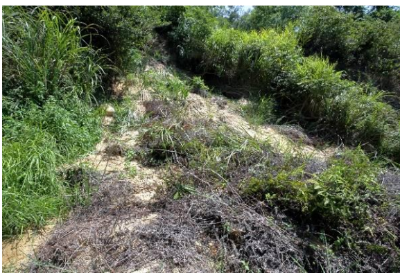
照片 11：105.06 月陷谷地最高處防砂壩南側邊坡大片土石崩落
