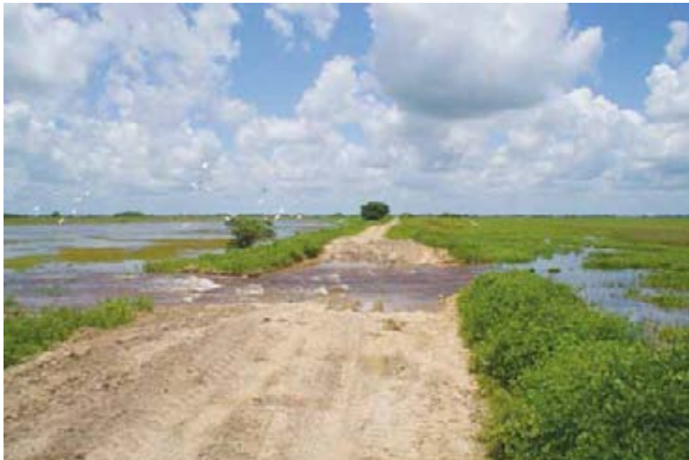
Figura 11.6.7 Rotura del dique Manirito. Foto: A. Rial.
