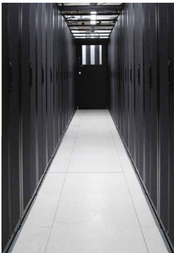
Kuva 10 Kanavuoren valmis konesali
