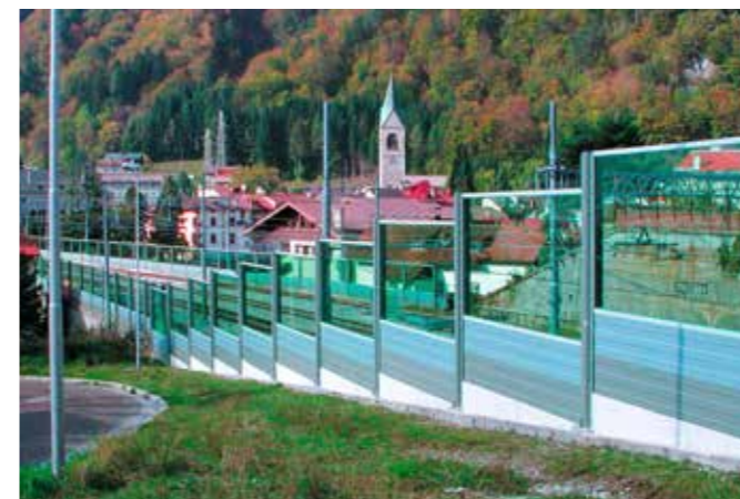
Noise barrier, Pontebba, Udine PLEXIGLAS® Soundstop XT ABB installazioni Spa, Milano
