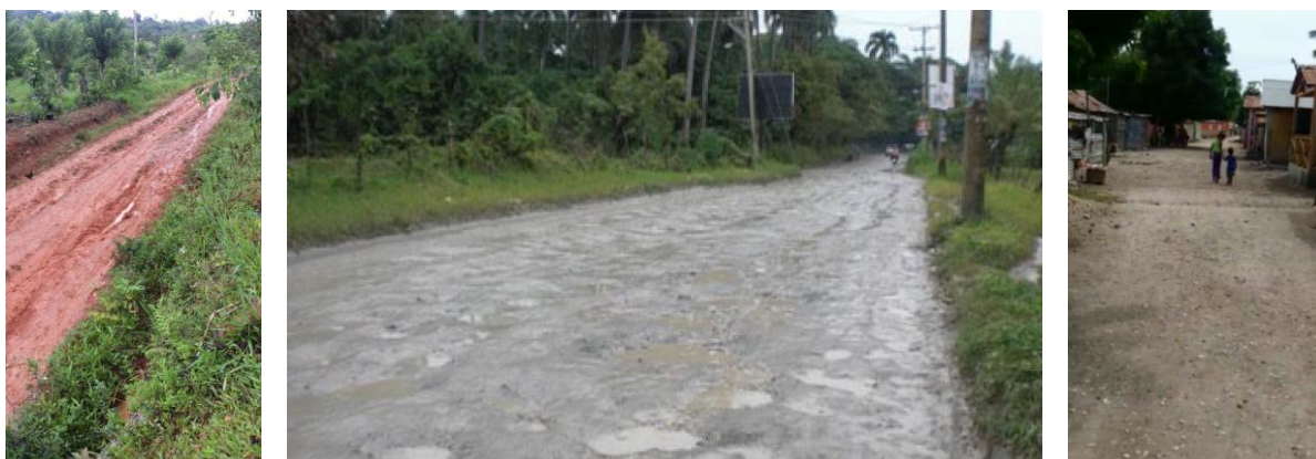
Figura 7: Estado de los Caminos de Acceso en Algunas Comunidades de San Cristóbal
