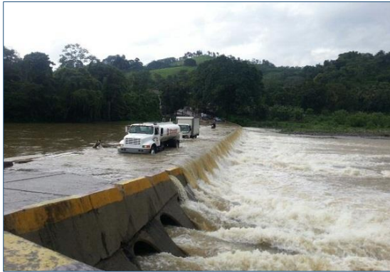
Crecida del Río Haina arriesga el puente y sus usuarios Ago.2017
