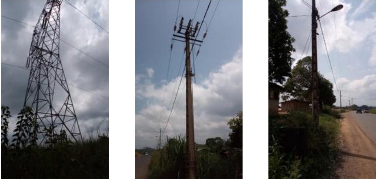
Figure 153 : De gauche à droite : lignes de haute, moyenne et basse tension
