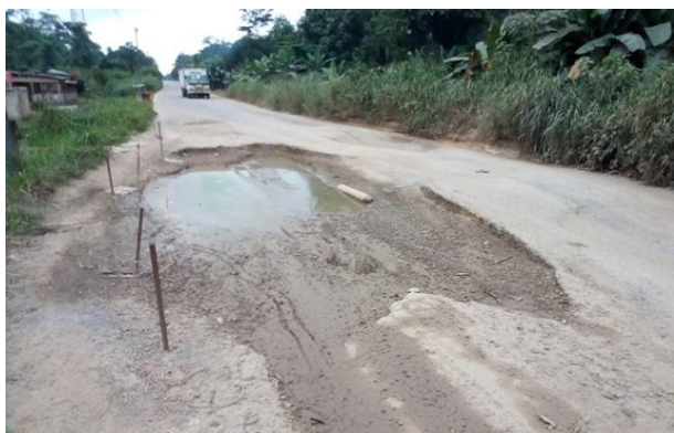
Figure 162 : Portion de route endommagée à Ebel Akok
