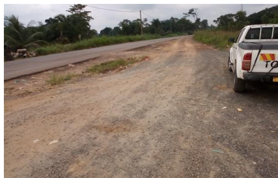
Figure 163 : Route endommagée à Okolassi
