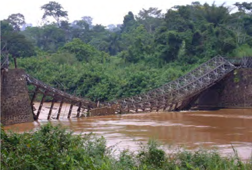
Pont effondré sur la rivière Ituri.
