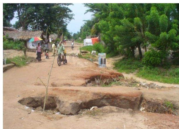
État de la route à Bumba, croisement Mobutu.
