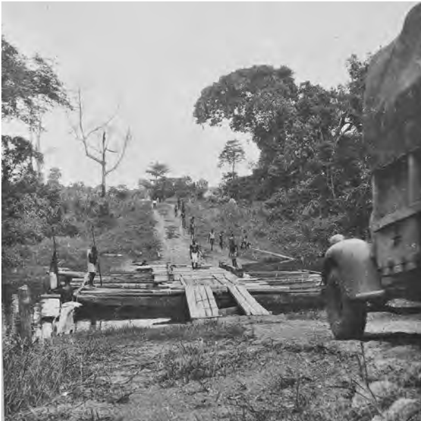
À Nzale, sur la route de Yakoma à Mobayi-Mbongo, ce ponton permet la traversée de la rivière Dondi.
