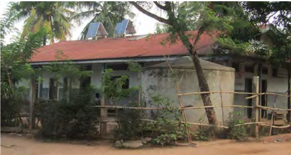
Un centre de santé équipé de panneaux photovoltaïques au quartier Tabac à Gbado-Lite.
