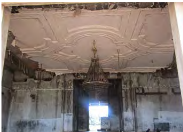
Vues intérieures du palais de Gbado-Lite dans son état de destruction. (Source : archives RTNC.)
