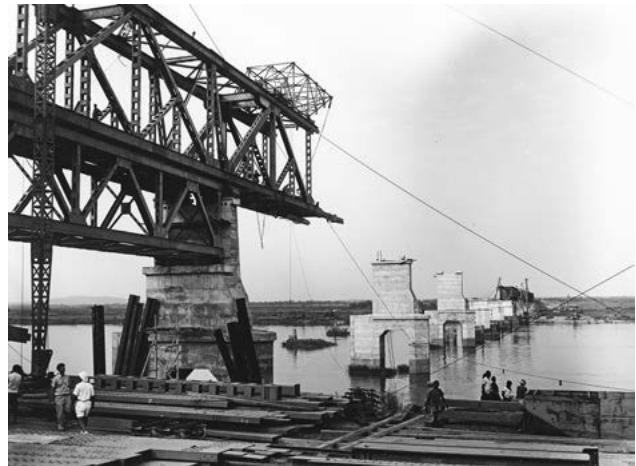
Pont de Zofu (795 m) sur la jonction Kabalo-Kamina, en construction. (HP.1956.22.79, collection MRAC Tervuren; photo C. Lamote [Inforcongo], © MRAC Tervuren.)
