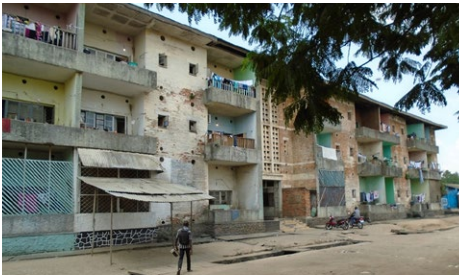
Le bâtiment de l'hôtel Wagenia délabré à la suite des nombreuses violences subies. (Photo équipe locale/IRSA ; février 2020.)
