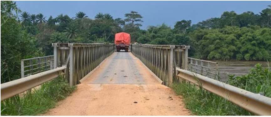
Pont sur la Lindi à 36 km de Kisangani, sur l'axe Kisangani-Banalia. (Photo équipe locale, 2017.)
