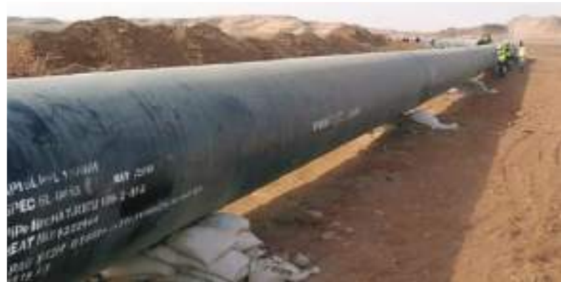
Pipeline de l'aquifère de Disi (Halcrow.com)
